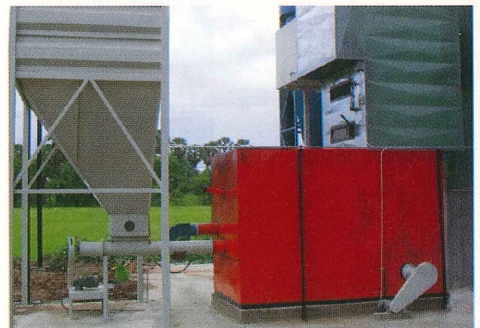
粗糠燃燒爐/熱交換式熱源
