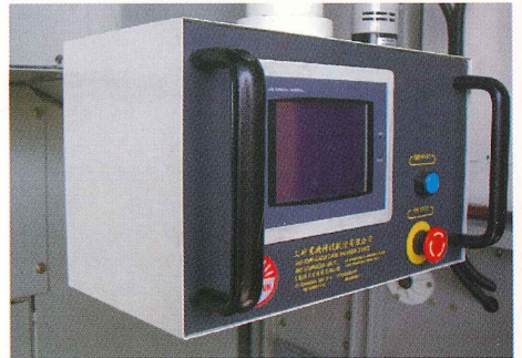
PLC 控制系統/觸控銀幕
