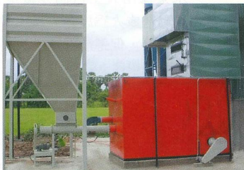
粗糠燃燒爐/熱交換式熱源
