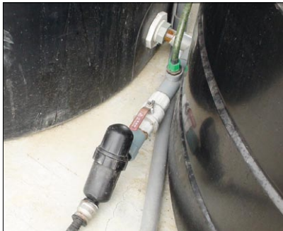
圖4 為了防止堵塞，必須裝設過濾器，定期清洗
