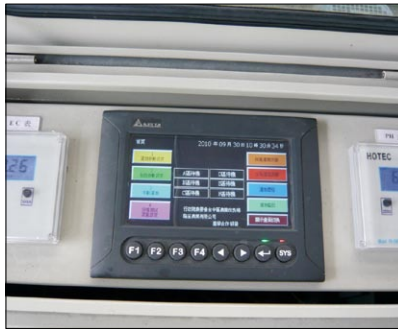
圖2 操作者與肥灌主機溝通設定操作參數的主角：人機介面
