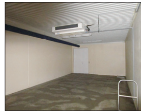
圖88 設置之恆溫恆濕15~16°C、75% R.H.的種蛋暫存室
