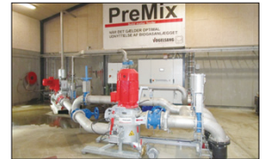
圖108 固態生質料粉碎供料設備
