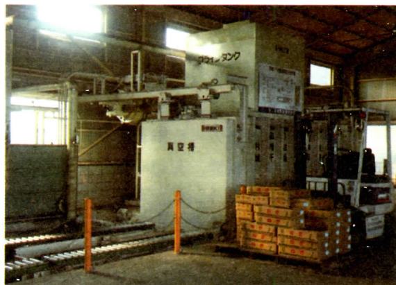
圖二 八千代農協真空預冷設施
